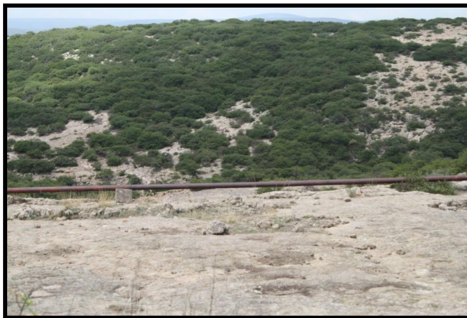
Fotografía 10. Tubería que transporta el agua desde el manantial Los Güeros hasta la localidad de Ejido Patria. Ejido Patria, 30 de abril del 2015.
