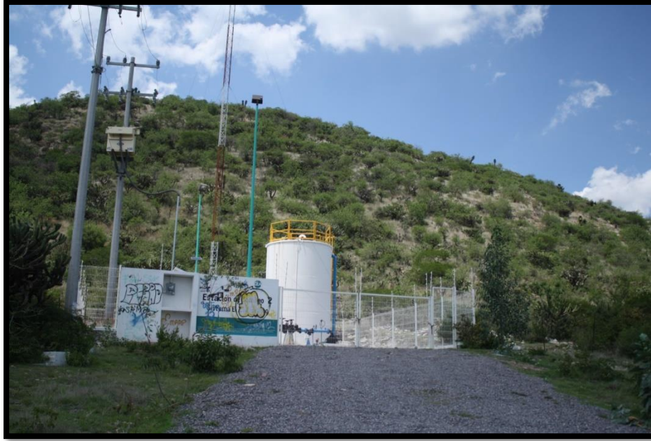
Fotografía 7. Estación de bombeo El Zamorano II. La Carbonera, 30 de abril del 2015.
