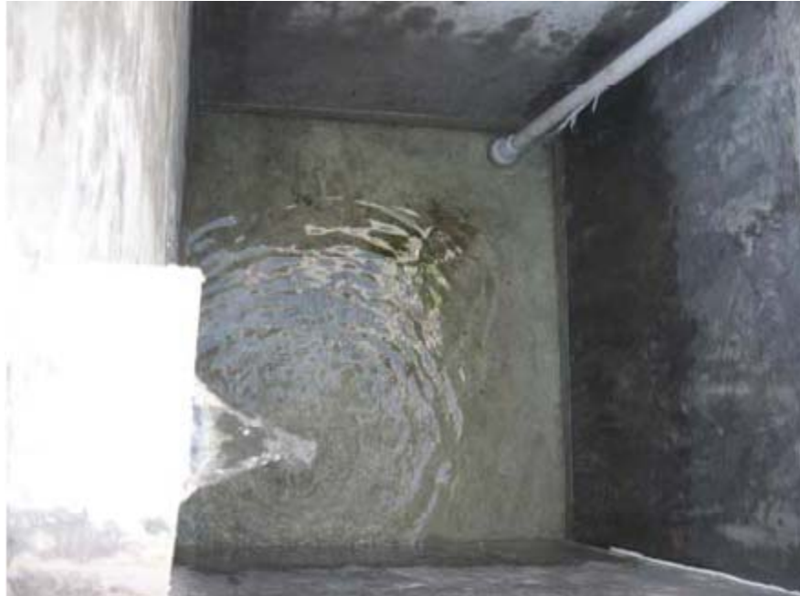
Figura 3.7 Depósito de almacenamiento final del agua
