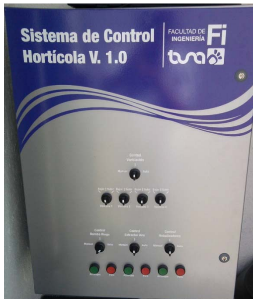
Figura 4.17 Panel de potencia para sistema de automatización acuícola
