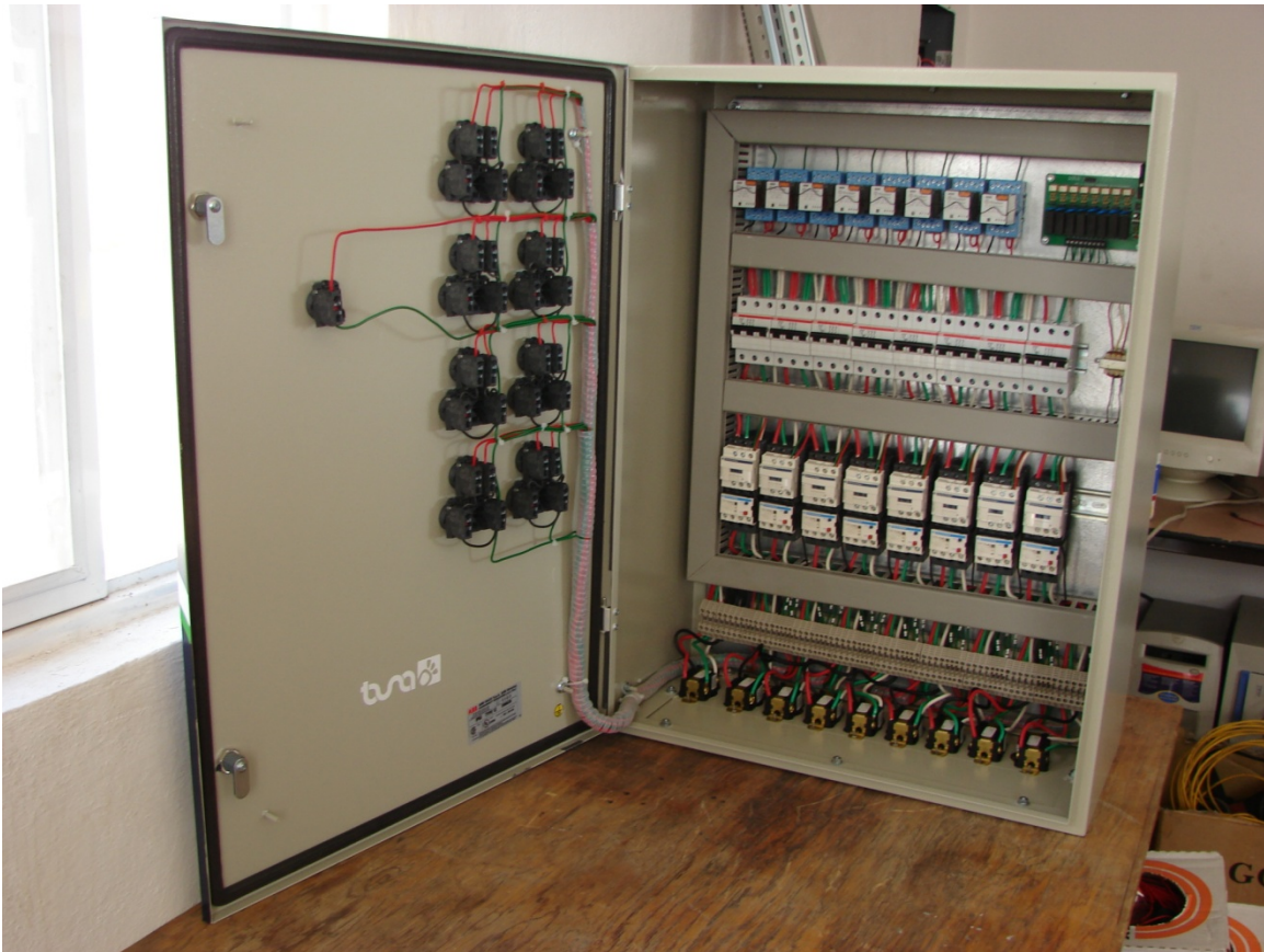
Figura 3.28 Panel de potencia para activación de actuadores
