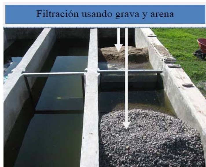
Figura 3.4 Etapa de filtración mecánica usando grava y arena
