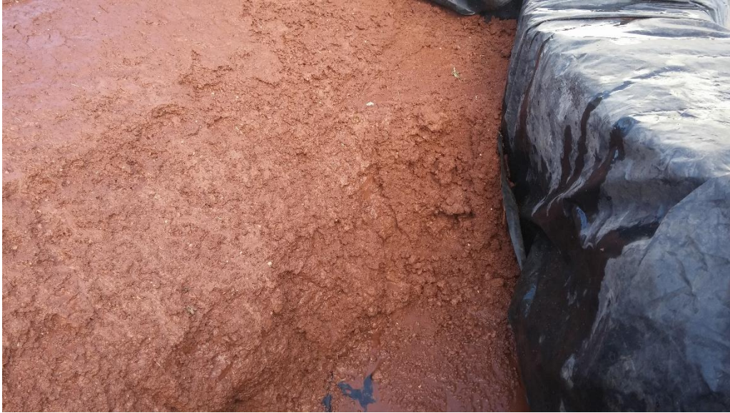
Figura 5.12 Erosión en el talud de pendiente constante
