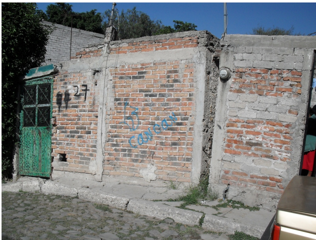
Figura 6.1 Daños graves visibles en el exterior de una vivienda en la colonia la Sierrita.
