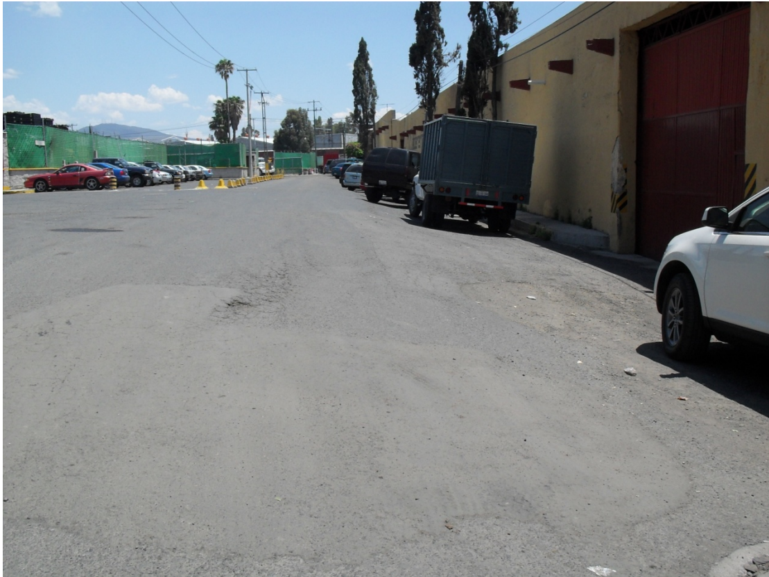
Figura 7.2 Foto tomada al Diferencial vertical en Acceso II.
