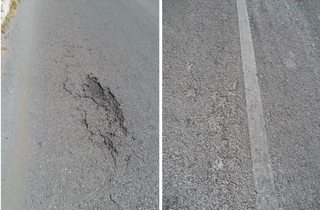
Figura 4a y 4b. Carreteras con desintegraciones que propician la formación de baches.
