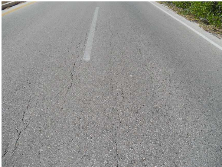
Figura 3. Carretera con agrietamientos longitudinales.
