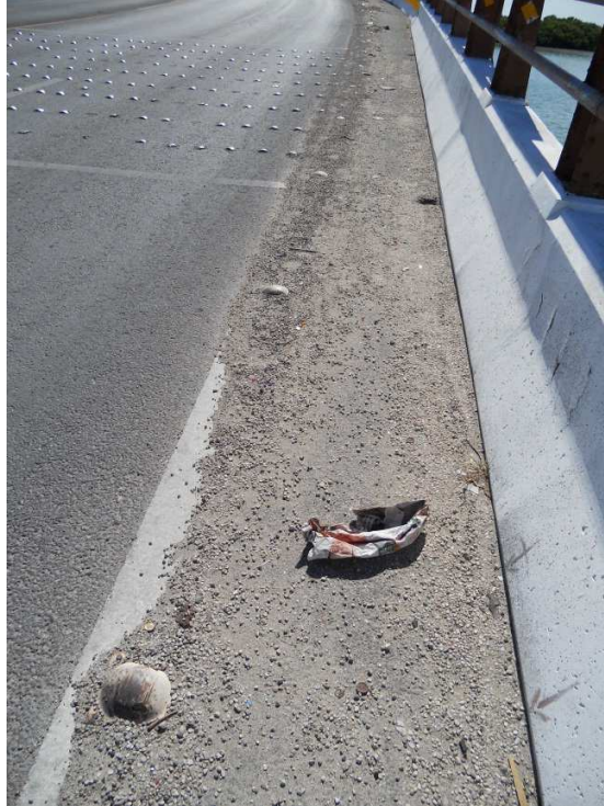
Figura 2. Carretera con desprendimiento de agregados.
