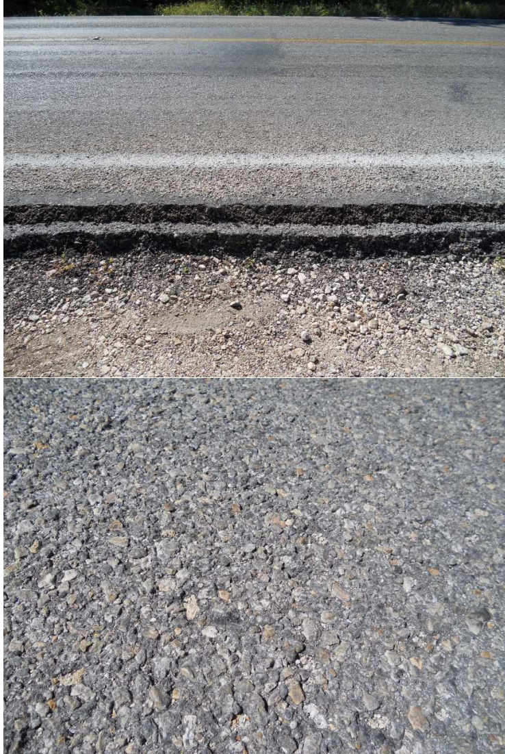
Figura 1a y 1b. Carreteras con desprendimiento de la película de asfalto del agregado.
