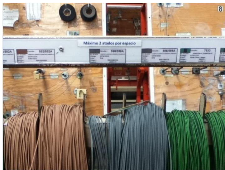
Figura 37. Rack de colocación de circuitos en modelo 2013
