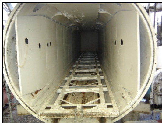
Figura 13. Empresa B: Túnel de enfriamiento a base de amoníaco.
