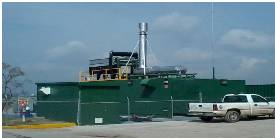
Ilustración 9. Planta Generadora de Energía del Relleno Sanitario Municipal
