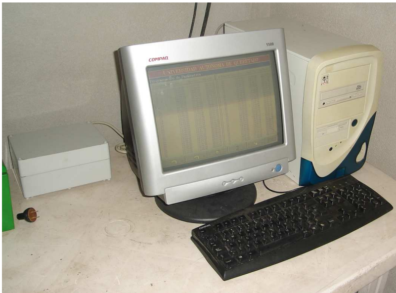
Figura 28. Equipo control de clima
