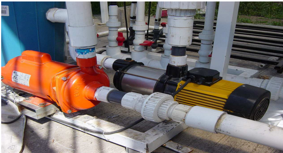
Figura 14. Sistema de bombeo
