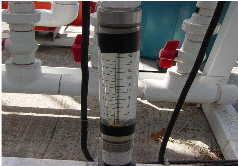
Figura 20. Medidor de flujo
