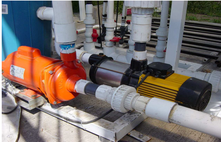
Figura 29 Sistema de bombeo del Campus Amazcala
