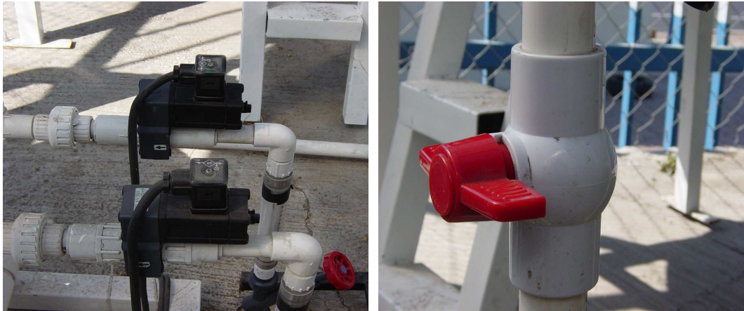
Figura 36. Válvulas instaladas en Campus UAQ Amazcala
