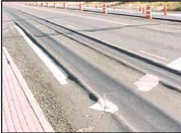
(a) Roderas longitudinales
