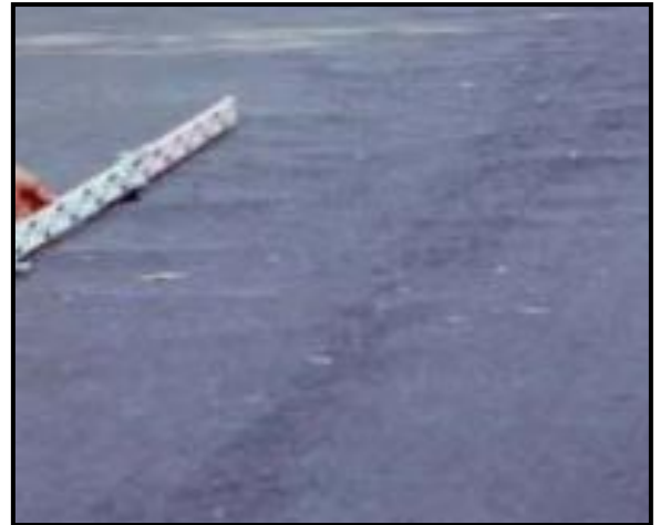
(b) Roderas transversales
