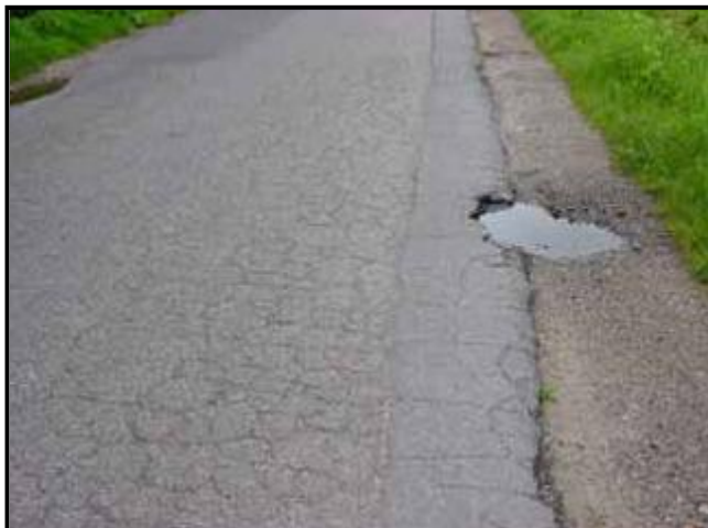
(a) Fatiga con desprendimiento o fractura
