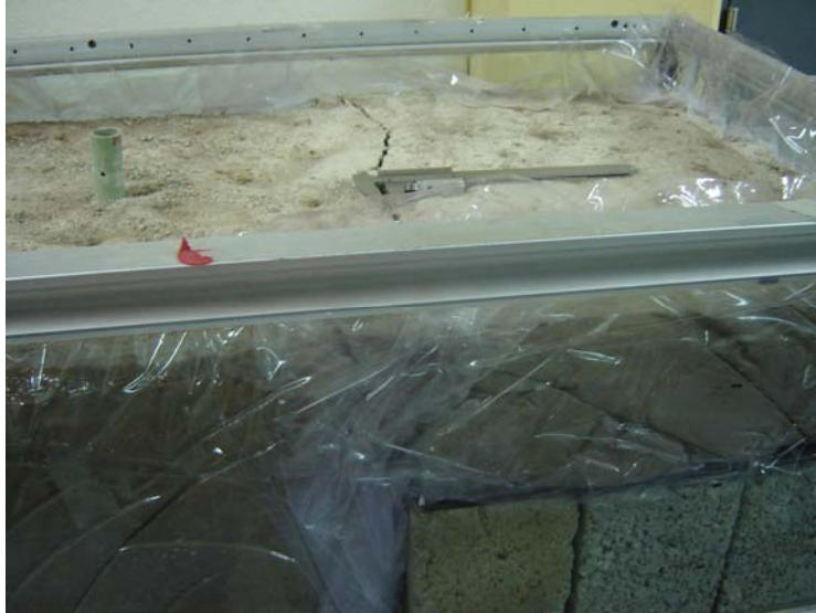
Figura 5.9. Vista del agrietamiento observado al finalizar la prueba del modelo 3, se observaron aberturas de hasta 3 mm únicamente en la zona ubicada sobre el escalón de 14.8 cm de espesor.
