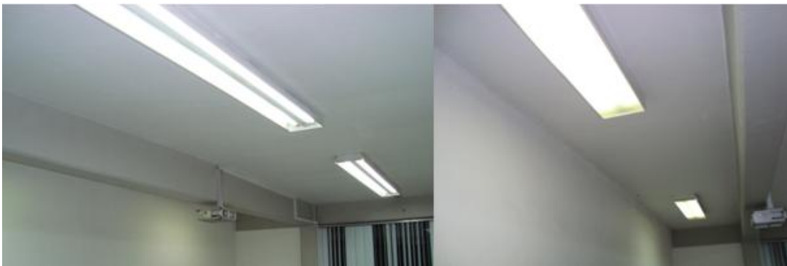
Figura 3.5 a Luminarias del aula 19.
