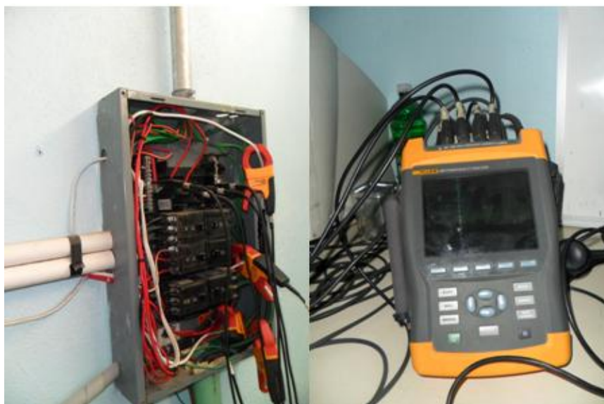
Figura 3.17: Conexión del analizador FLUKE 434 al tablero de distribución eléctrica del edificio H.
