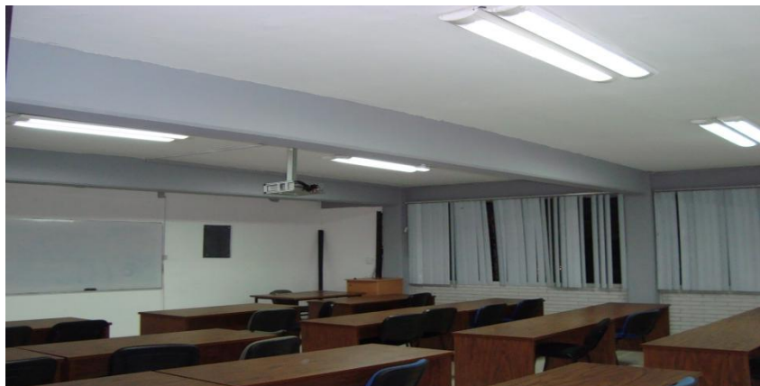
Figura 3.5 f Luminarias de la Sala de juntas.
