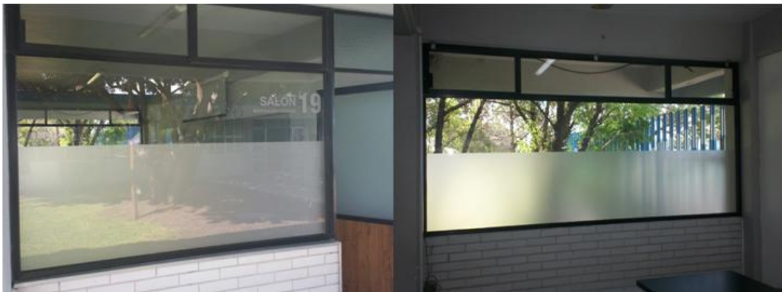
Figura 4.5: Ventanas de las aulas del edificio H revestidas con películas de vinil.
