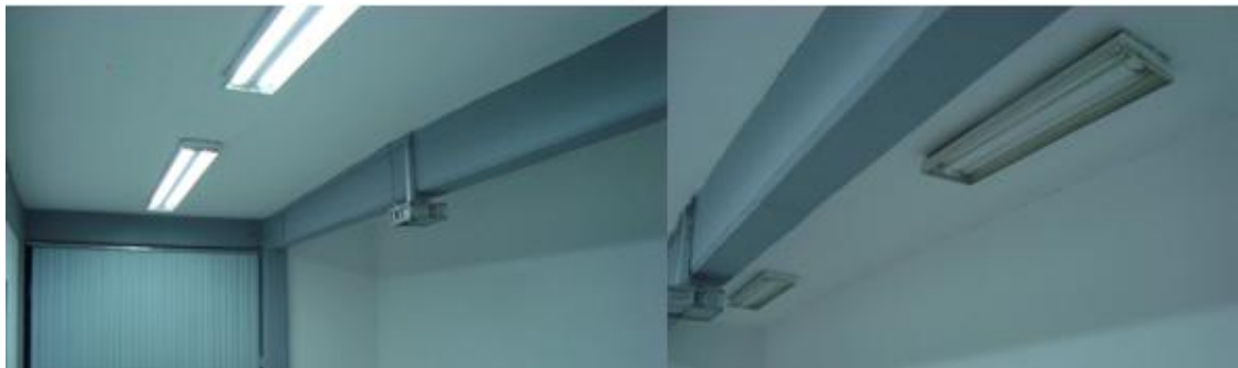
Figura 3.5 d Luminarias del aula 22.
