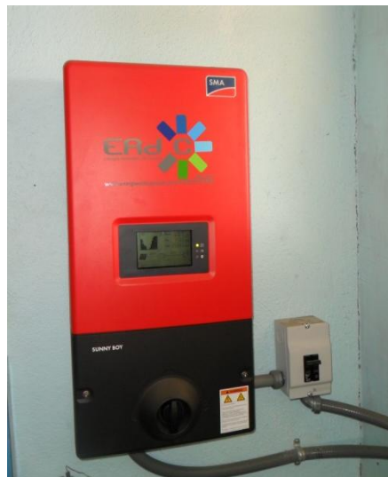
Figura 3.13: Inversor Fotovoltaico instalado en el cuarto de control del edificio H.
