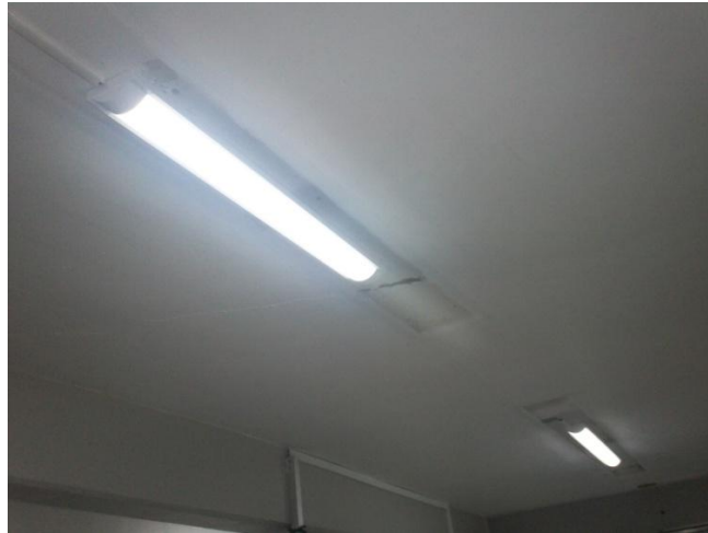
Figura 4.4: Luminarias instaladas en las aulas 19, 20, 22, y 23.
