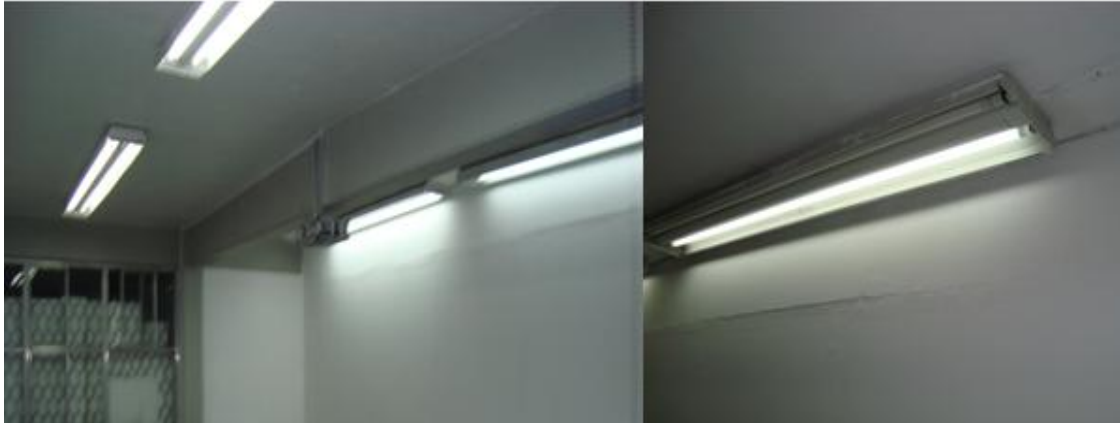
Figura 3.5 e Luminarias del aula 23.
