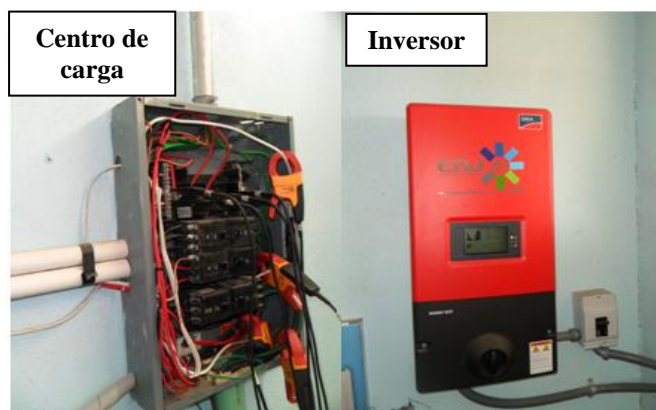
Figura 3.2 a Cuarto de control del edificio H.
