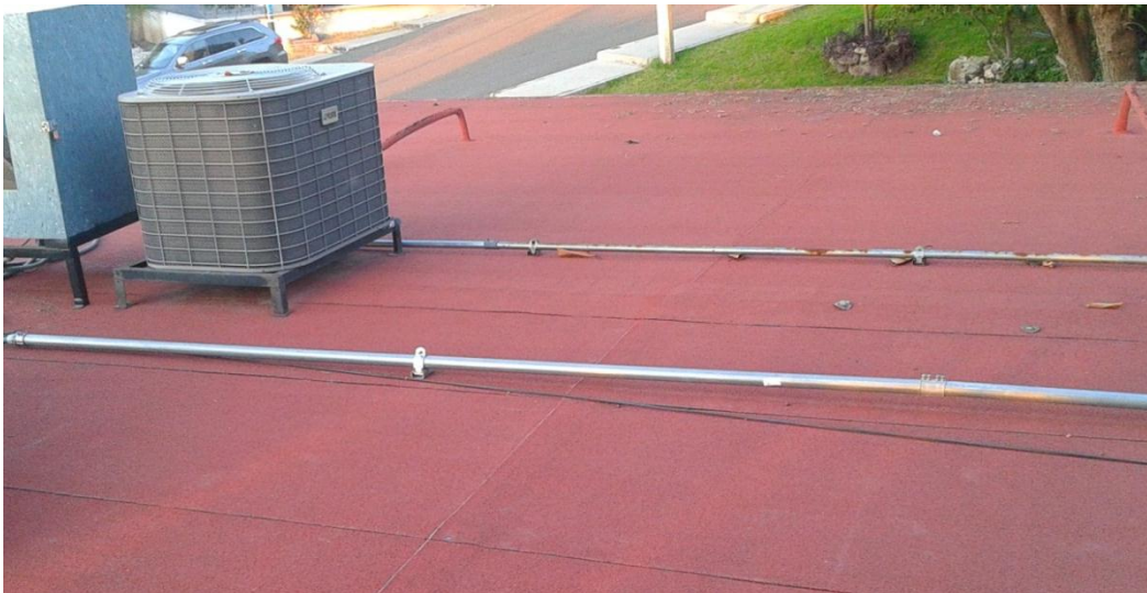
Figura 3.2.2. Canalización del cableado.
