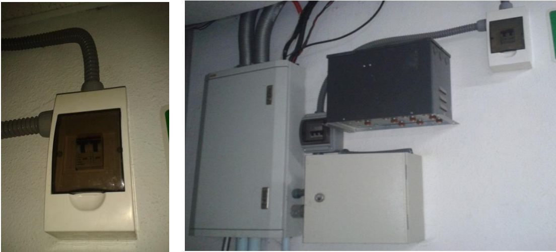
Figura 3.1.8.1. Interruptores de AC
