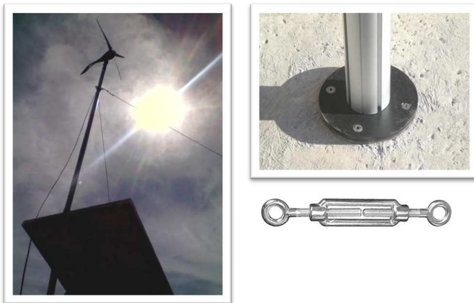
Figura 3.7 Soporte a piso y tensores 1 y 2 colocados.
