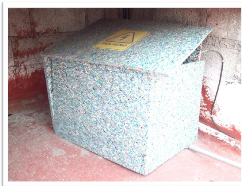
Figura 3.12 Protección Intemperie del sistema de generación de energía.
