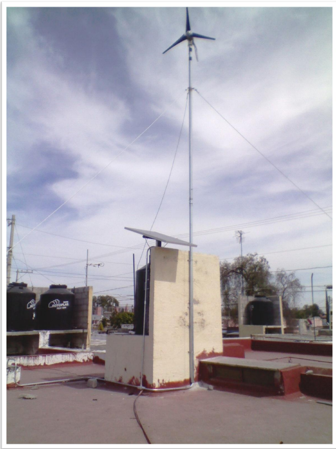
Instalación Completa del Equipo de Generación de Energía Renovable Eólico-Solar
