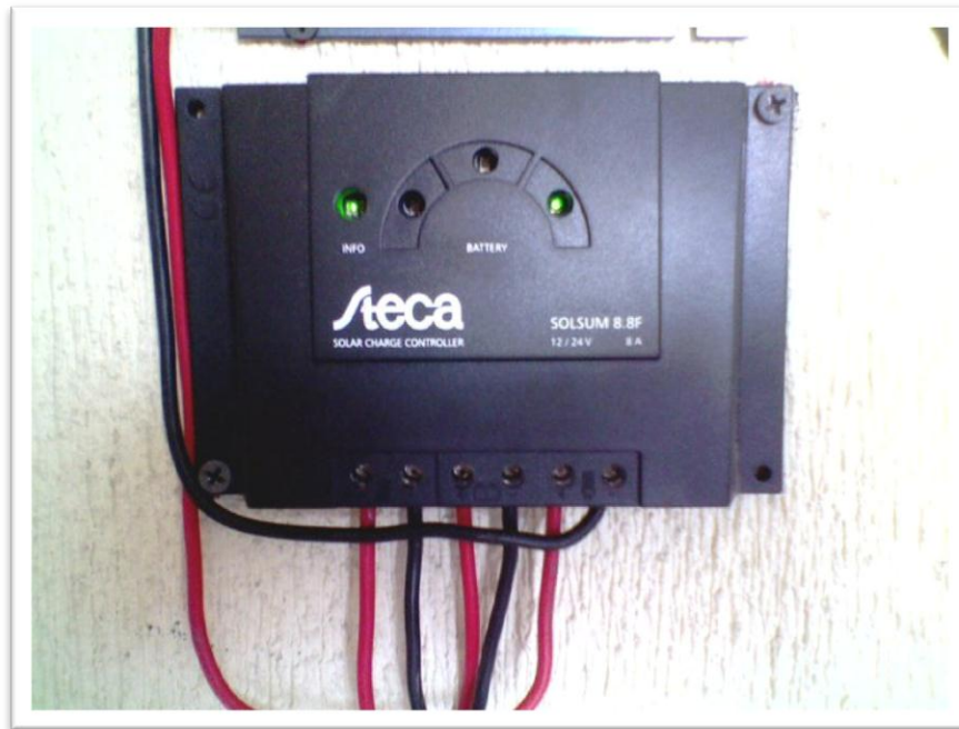
Figura 3.13 Control automático de protección para Sobre carga.
