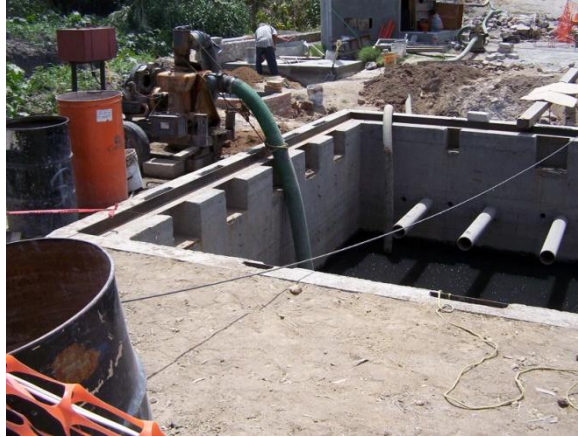
Foto 3.9. Tratamiento de aguas residuales.
