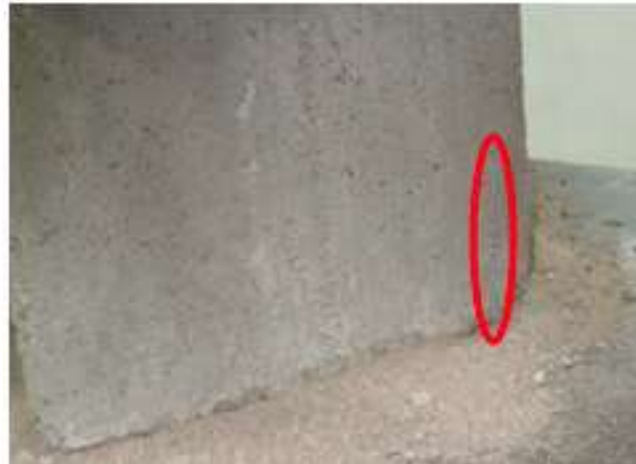
Figura 4.2.1. Aparición de primera grieta en un bloque
