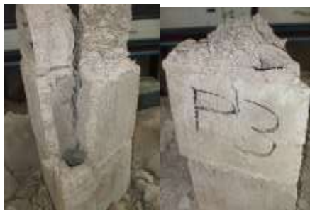
Figura 4.3.4. Grietas longitudinales en pilas con juntas de mortero
