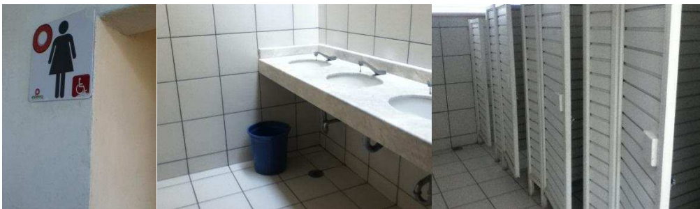
1.27 Izquierda: Señalética baños del polideportivo, Centro: lavamanos de los baños no acondicionado para personas con discapacidad, Derecha: las puertas de los baños no permiten el acceso a personas con discapacidad.
