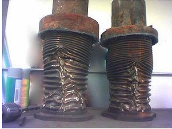
Figura 4.4. Material destruido por un golpe de ariete
