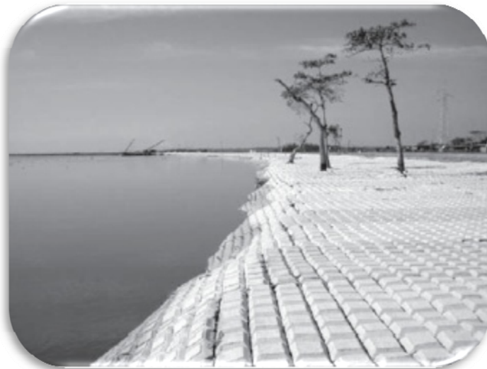
Figura 1.1 Protección marginal con tapetes de concreto ( www.projectlink.com.au/.../thb_icmtqngtye4h.jpg , consultado en 2009)
