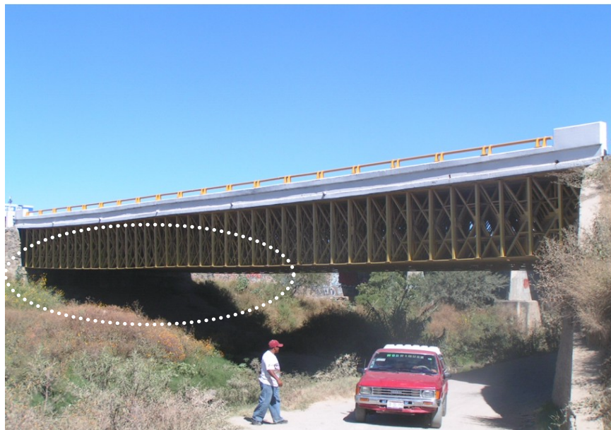
Figura 5.52. Deflexión importante en el Puente.
