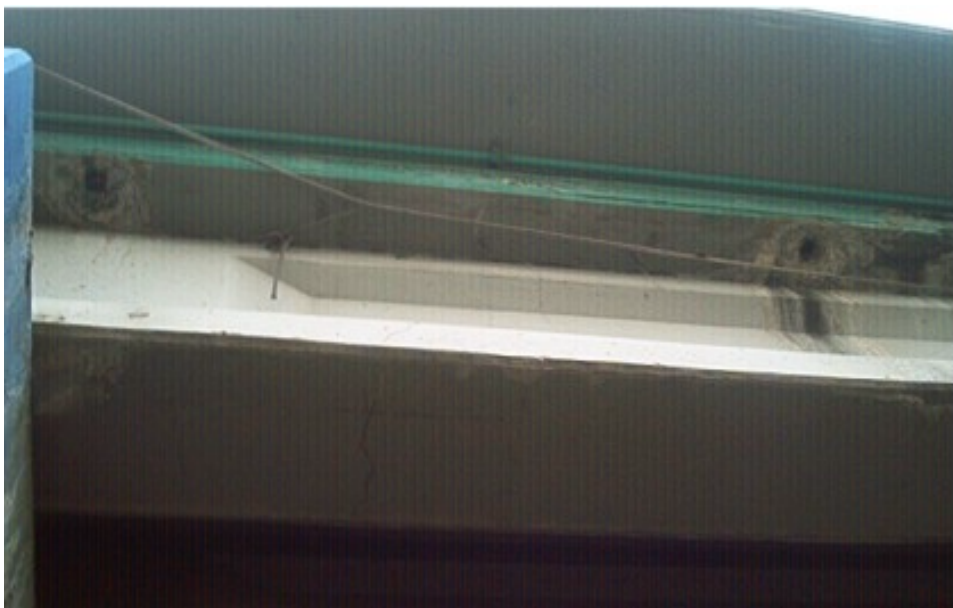
Figura 5.44. En la superestructura se notan los escurrimientos.
