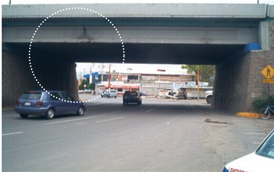
Figura 5.50. Golpe en la parte inferior de las vigas dejando en algunas partes al acero de la viga expuesto.
