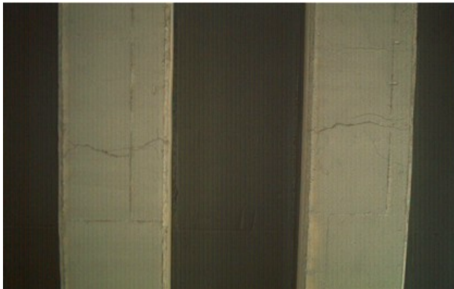
Figura 5.46 En la parte inferior de las trabes principales se observan grietas.
