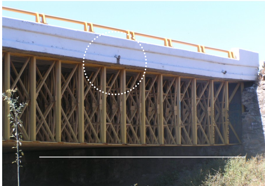
Figura 5.54. Escurrimiento y deflexión de la estructura.
