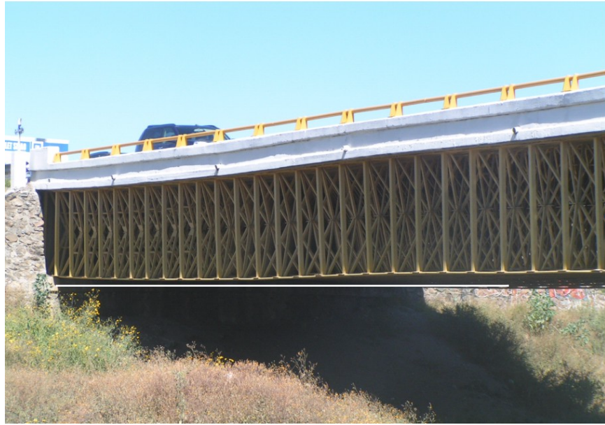
Figura 5.51. Deflexión importante en el Puente.
