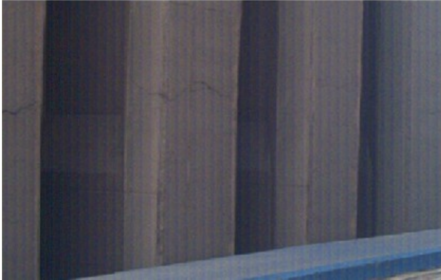
Figura 5.45. En la parte inferior de las trabes se observan grietas, a una distancia del apoyo aproximadamente igual al peralte de la viga.
