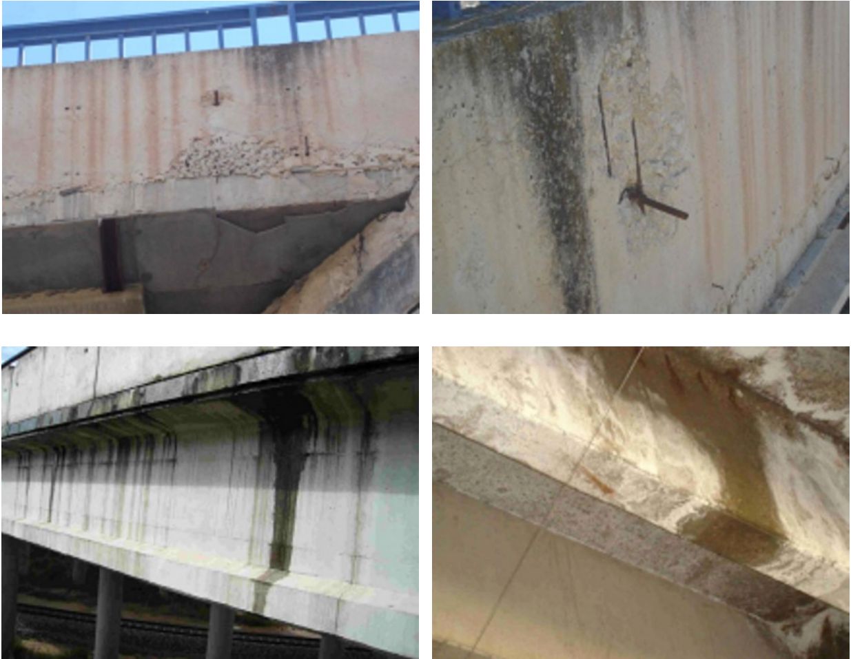
Figura 5.1 Patrón de Falla 1. Presencia de agua.
