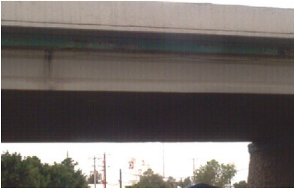
Figura 5.43. En la superestructura se notan los escurrimientos.
