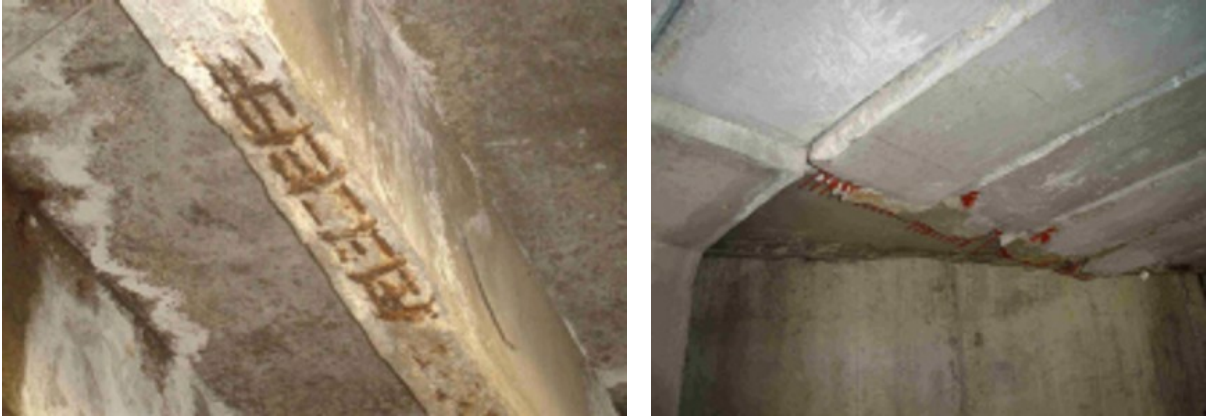
Figura 5.2 Patrón de Falla 2. Corrosión.
