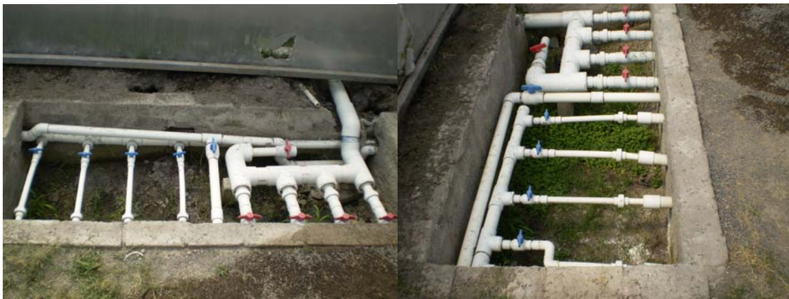
Figura 39. Instalación hidráulica del punto de entrada y salida de agua a los estanques.
