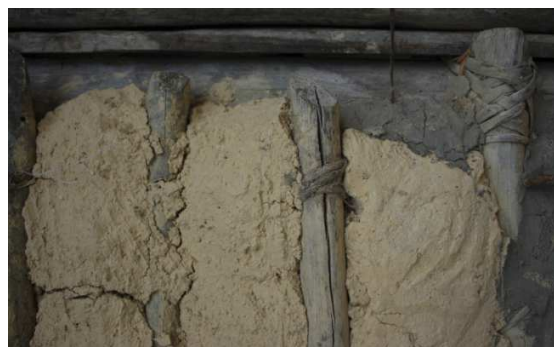
Fig. 3.5.2.1.40. Detalle constructivo de la técnica de Enjarre (“De tierra y varas. Una muestra de arquitectura vernácula en la Sierra Gorda de Querétaro”, Secretaria de Desarrollo Urbano y Obras Públicas de Querétaro, Querétaro, 2009).
