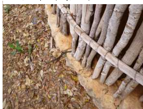
Fig. 3.5.2.1.73. Trama de ramas base de la técnica de Bahareque en vivienda tradicional maya, Yucatán.
