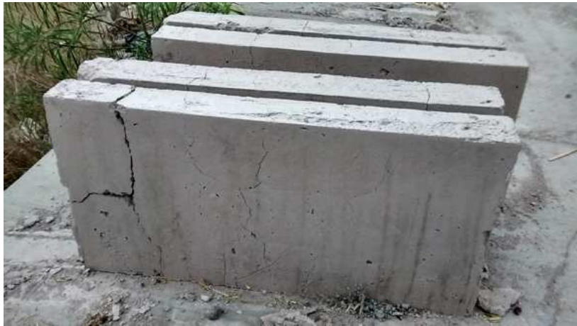
Fig. 5.4.3. Paneles PF0101 con fracturas y grietas por contracción/retracción
