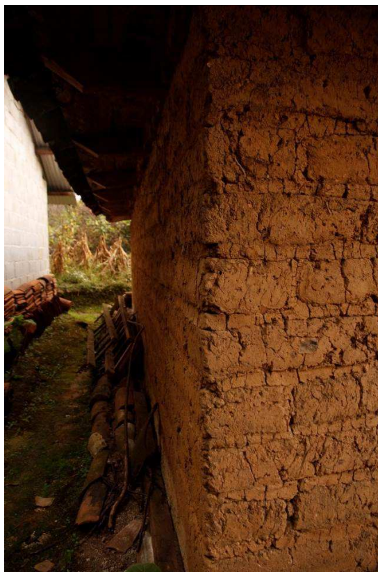
Fig. 3.5.2.1.66. Detalle de construcción con tierra en estado de deterioro en HUixpan, Chiapas. Fuente: Varun Thautam.
