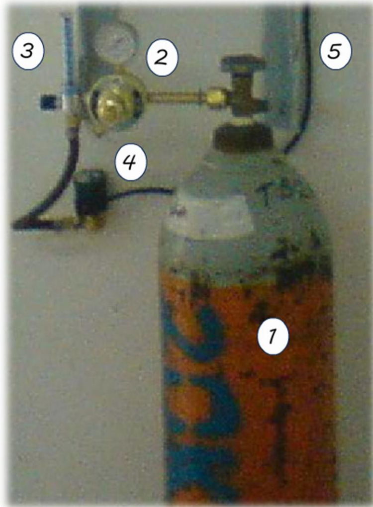
Figura 2.4. Tanque, manómetro, regulador y válvula solenoide para el CO 2 .
