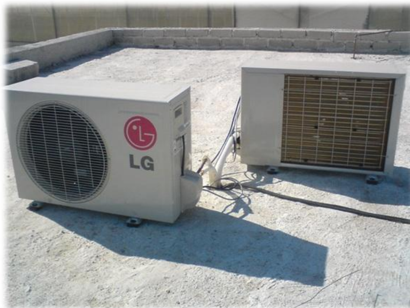
Figura 3.4. Actuadores aire frio y calientes radiadores instalados en el techo.
