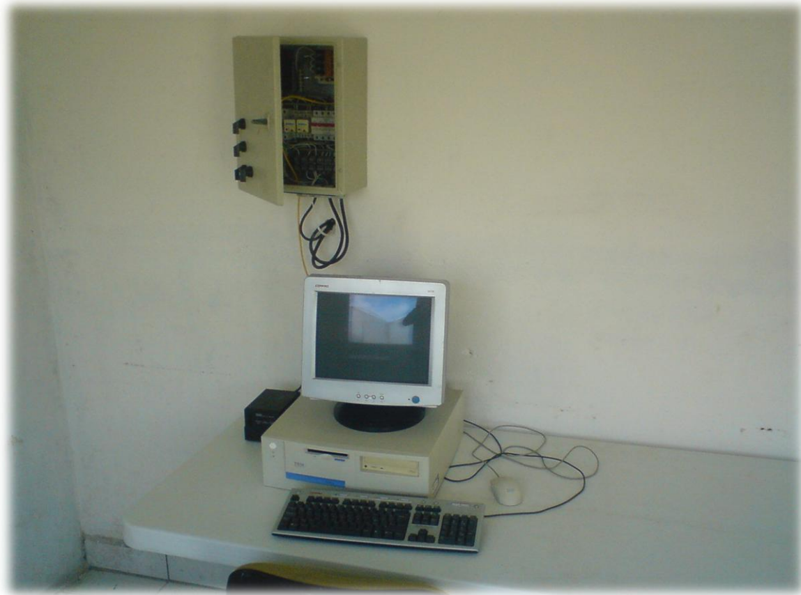
Figura 3.5. Área de control en el cuarto antesala, que conforma la computadora, regulador, mesa y el panel de control.
