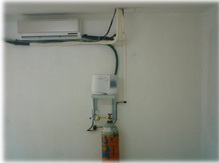
Figura 3.3. Actuadores ya instalados dentro de la cámara de Aire Frio y caliente cortina interna, Humidificador y tanque para CO 2 con su válvula selenoide.
