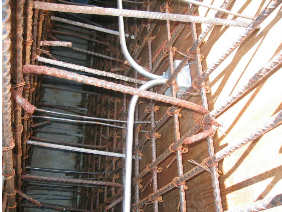
Figura 6.7.- Muestra la instalación eléctrica ahogada en los muros de sostenimiento.
