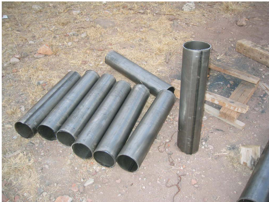
Figura 6.8.- Tubería de 3 pulgadas de espesor y 50 cm de longitud alojada.
