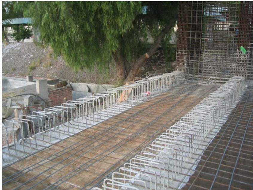
Figura B.15.- Primera capa de acero de refuerzo de losa de reacción (14 de Diciembre de 2006)
