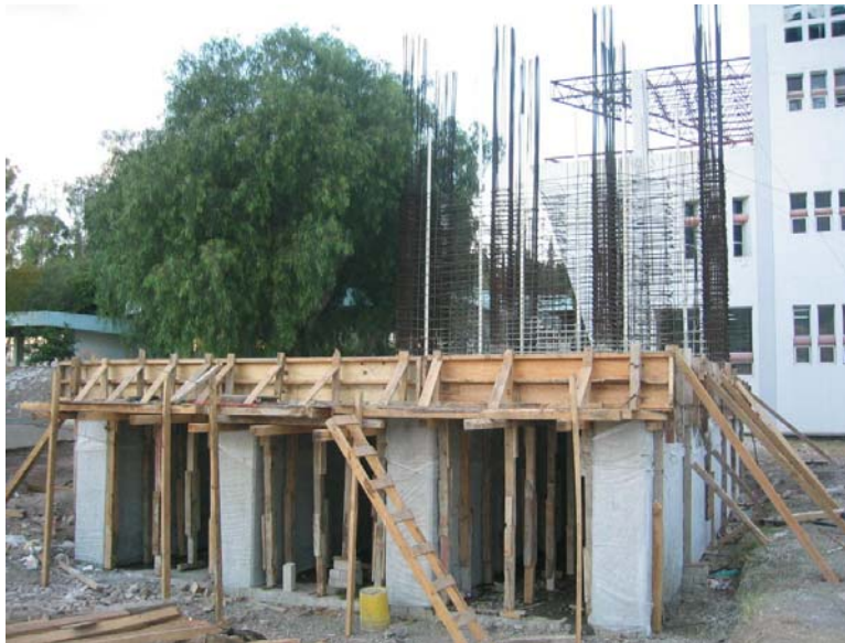
Figura B.19.- Aspecto general del muro de reacción al Final de la ETAPA 2. (22 de Diciembre de 2008 por la tarde)
