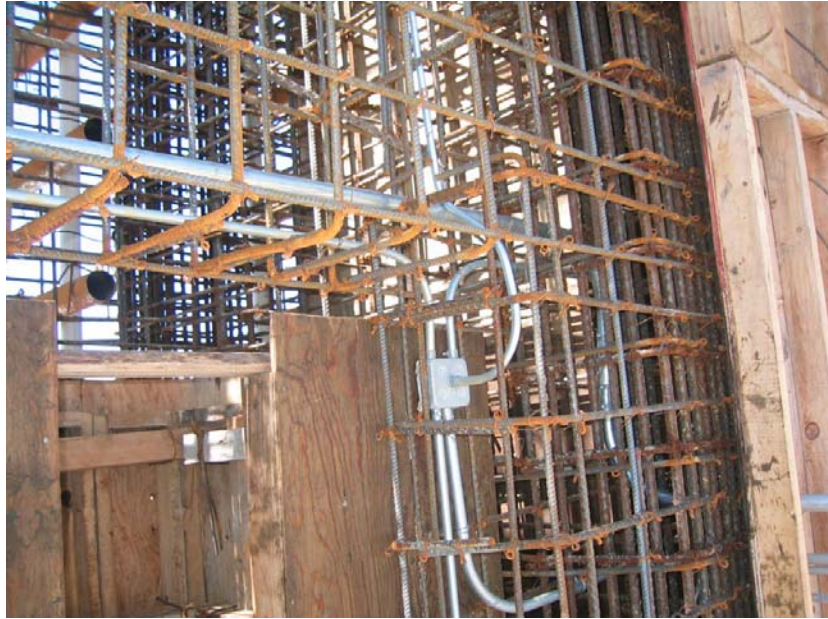
Figura B.24.- Instalación eléctrica para muro de reacción y tablero de carga principal, parte posterior del muro de reacción. (11 de Febrero de 2007)
