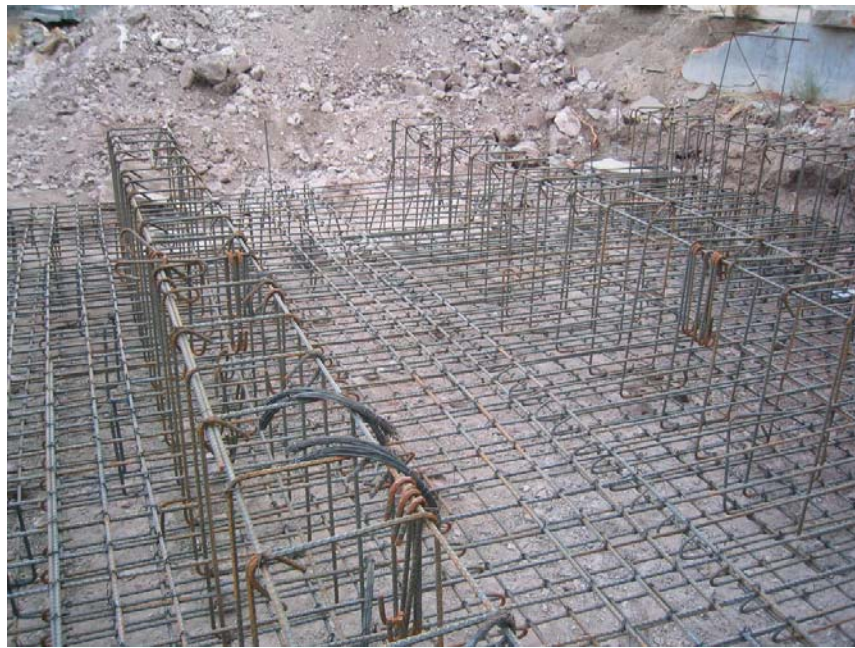
Figura B.3.- Segunda capa de losa de cimentación y estribos para cortante de muros (22 de Mayo de 2005)
