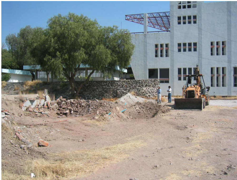
Figura B.1.- Inicio de los trabajos de limpieza de sitio de cimentación (20 Febrero 2005)
