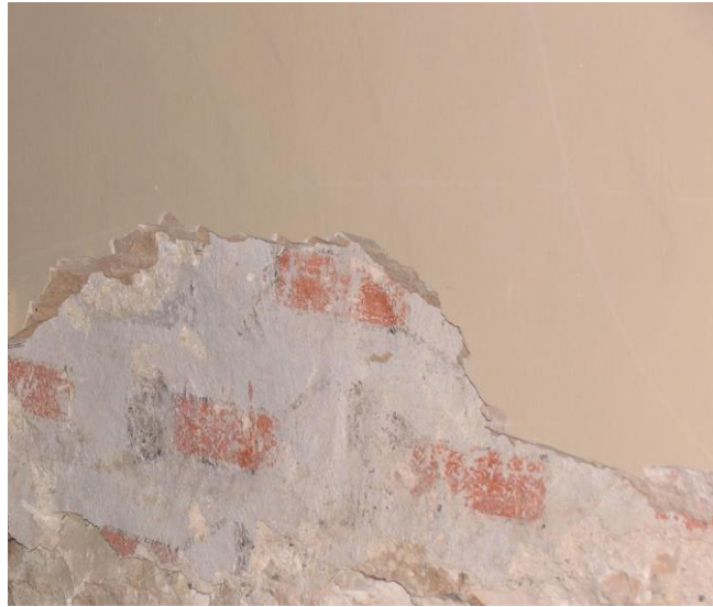
Figura 7. Desgaste Mortero de cal.
