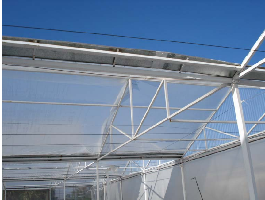
Figura 1.5 Se observa el desprendimiento de la canaleta debido al hundimiento de ciertas columnas.
