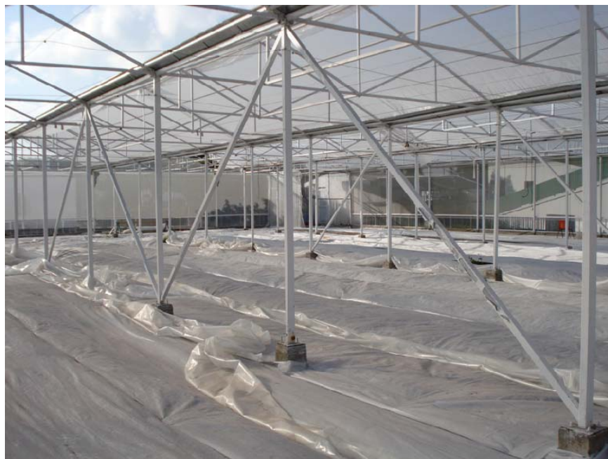
Figura 1.4 Se observan varios perfiles diagonales entre cada marco. Estos perfiles se colocaron para controlar el hundimiento de ciertas columnas.
