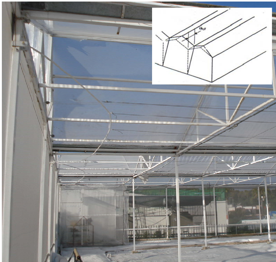
Figura 1.1 Se observa un desplome vertical en las columnas perimetrales y en las paredes frontales del invernadero encargadas de soportar parte de la carga de cultivo.
