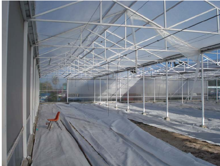
Figura 1.2 Se observa un desplome vertical en las columnas perimetrales y en las paredes laterales del invernadero encargadas de soportar parte de la carga de cultivo.
