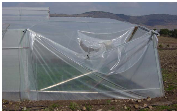
Figura 1.6 Colapso parcial de la estructura debido a la lluvia en el invernadero “El Bothe”, Amealco.
