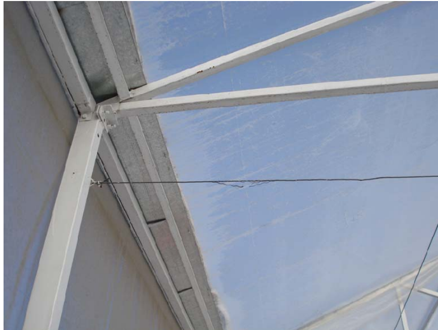
Figura 1.3 Se observa el cable tutor desgastado producto de la tensión excesiva en el mismo, debida principalmente al peso del cultivo.
