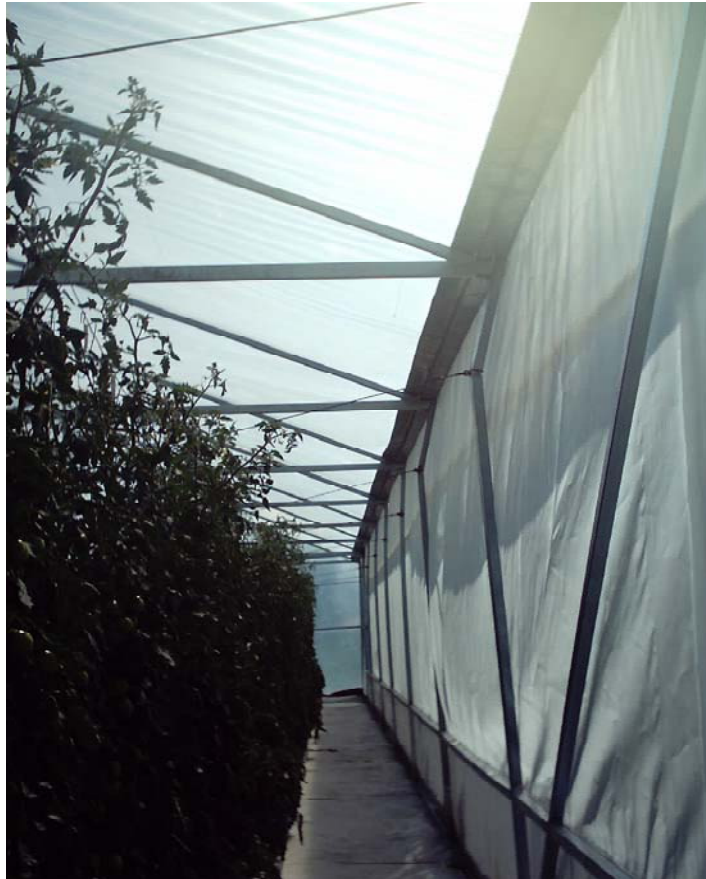
Figura 1.7 Pandeo de columnas debido a la excesiva tensión en los cables producto de la carga del cultivo. Invernadero “Tecozautla”, ubicado en el Estado de Hidalgo.
