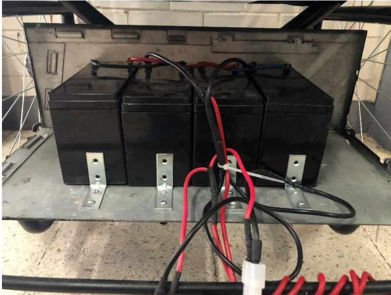
Figura 4.4 Ejemplo fotográfico de las baterías colocadas sobre la base instalada en la silla de ruedas
