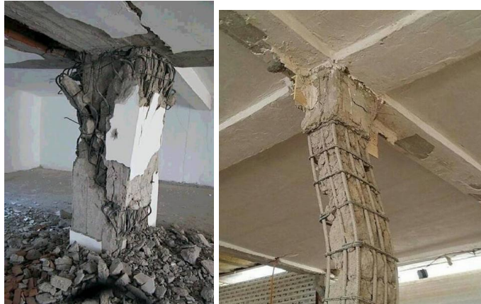
Figura 1.1.1: Fallas en uniones de concreto reforzado. (Izq.) Falla por cortante, (Der.) Falla por flexión. Fuente: https://www.arkiplus.com/fallas-en-columnas-de-concreto-armado/
