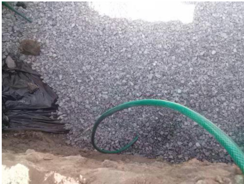
9-22 Colocación de 20 cm de grava y 4 mangueras enterradas a centros de cada lado del terreno excavado.
