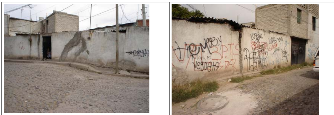
Figura V.3 Y V.4 Daños en construcciones en la colonia la Sierrita.
