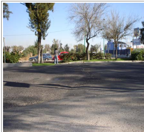
Figura V.10 Daño en carretera Prolongación Zaragoza frente a la tienda de autoservicio Gigante.
