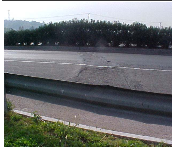
Figura V.9 Daño en carretera Boulevard Bernardo Quintana
