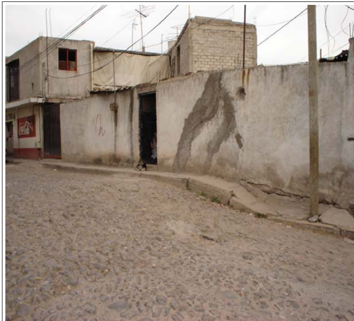
Figura V.16 Daño sobre banquetas en Calle Sierra Oriental colonia La Sierrita
