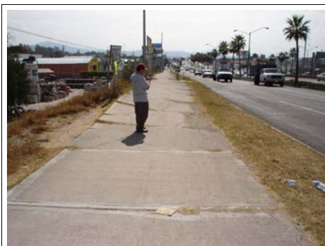
Fig. V.1 Daño en el B. Bernardo Quintana
