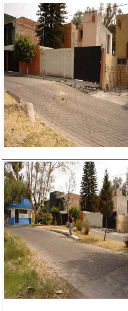
Figura V.5 Y V.6 Daño en casa habitación y calle Cayetano Rubio en la colonia Ensueño.
