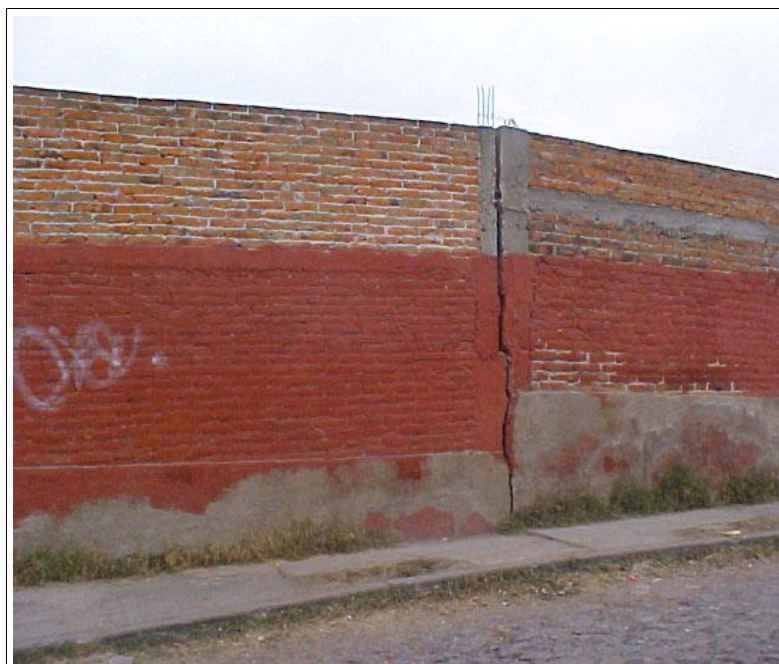
Figura V.13 Desplome y agrietamiento de muro en Calle de la Cruz San Pablo.
