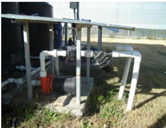
a) Tubería de estanque de agua
