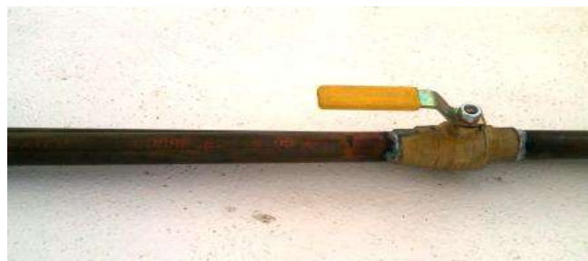
e) Tubería de gas fuera del aula de elaboración de productos lácteos
