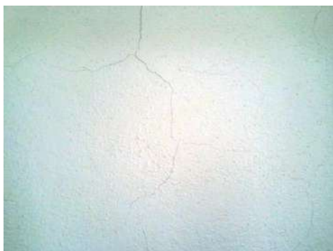
a) Grietas en pared interior del salón de elaboración de alimentos
