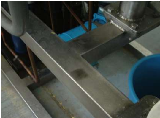
a) Tubería de gas de la máquina pasteurizadora
