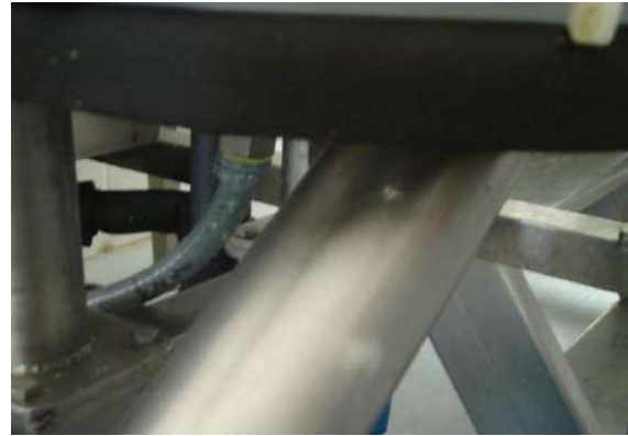
b) Tubería de manguera galvanizada de pasteurizadora
