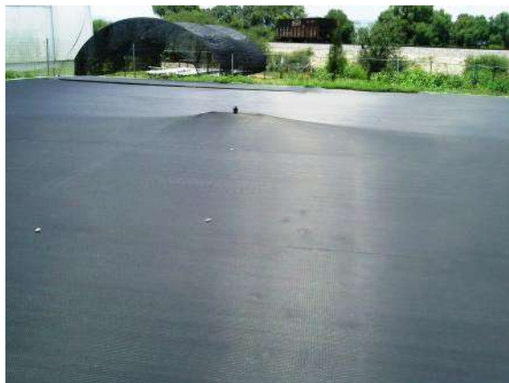
b) Estanque de agua cubierto
