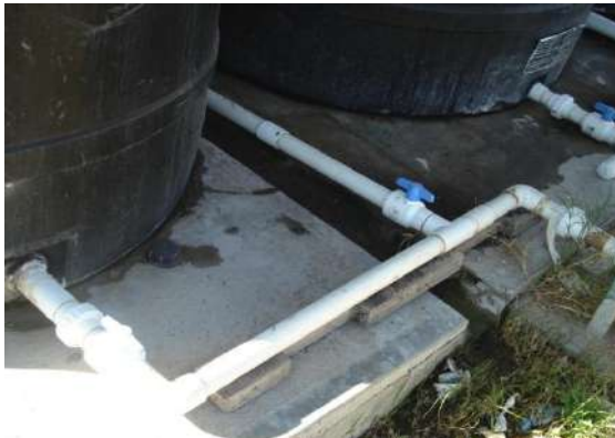
c) Tubería de pvc del estanque de agua
