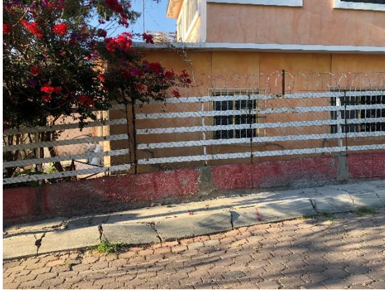
Figura 88. Daños a infraestructura habitacional en la calle Paseo del Gorrión.
