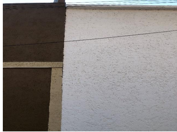
Figura 89. Daños a infraestructura habitacional en la calle Salvador Septién.
