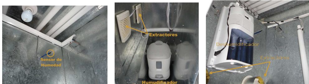
(a) Instalación de los sensores de humedad (b) Instalación del humidificador (c) Instalación del deshumidificador
