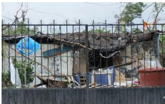
Figura 8 Daños causados en viviendas en Los Cabos, Baja California causados por la tormenta tropical Lidia en septiembre 2017. Fuente: The express Tribune, 2017
