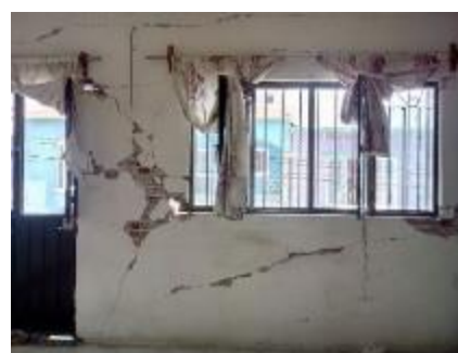
Figura 6 Vivienda con daño severo en el Municipio de Cautla en el Estado de Morelos, tras los sismos de septiembre 2017. Fuente: acervo propio.
