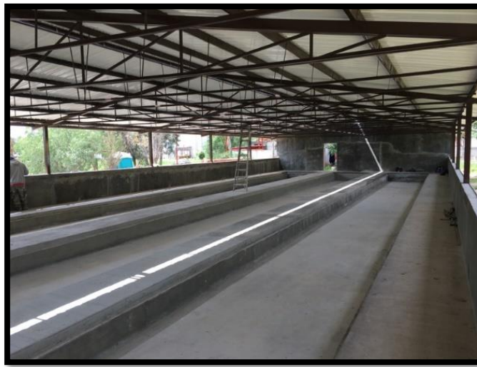
Figura 2. Fosa de almacenamiento drenada por gravedad utilizada como drenaje en una caseta para cerdas en etapa de maternidad en la zona de El Márquez, Querétaro.
