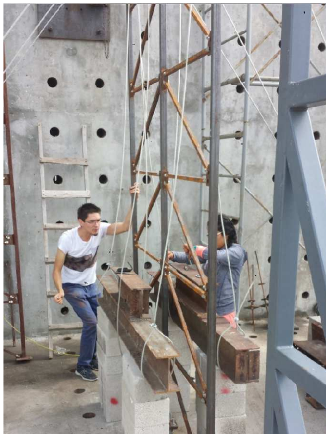
Figura 6-41 Nivelación de cargas gravitacionales en sistema de estructuración a base de panel simple.
