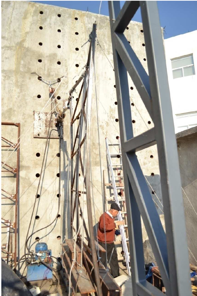
Figura 6-45 Falla debido a la flexo-compresión del sistema fuera de su plano.
