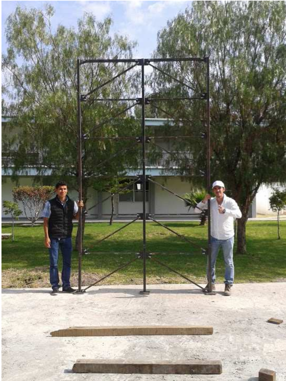
Figura 6-17 Proceso de izaje que excluyen el uso de equipo especializado in situ.
