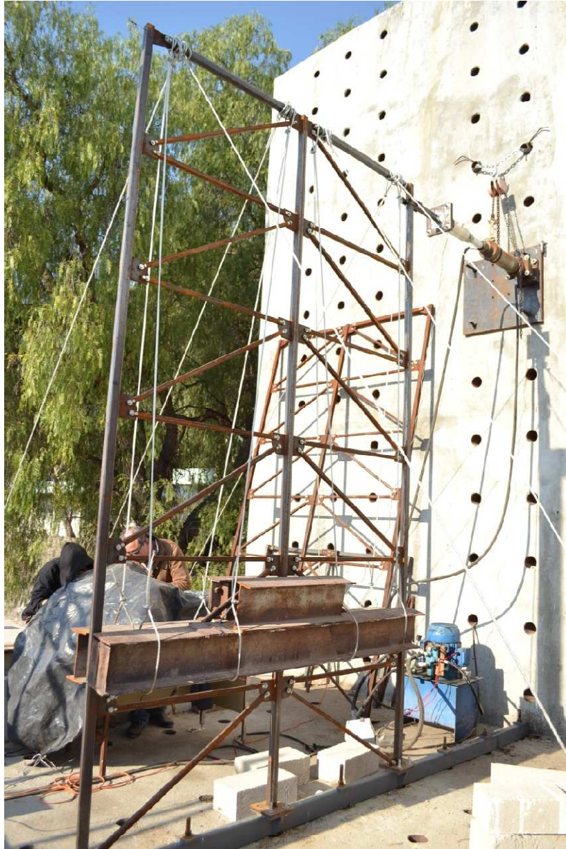
Figura 5-40 Aplicación de cargas de servicio momentos antes de la realización de la prueba.
