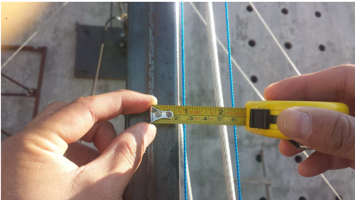
Figura 6-47 Deformación plástica fuera del plano (residual) de 1 pulgada en promedio como resultado de la descarga total del sistema estructural.
