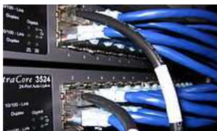
Figura 20. Conexiones en un switch Ethernet.
