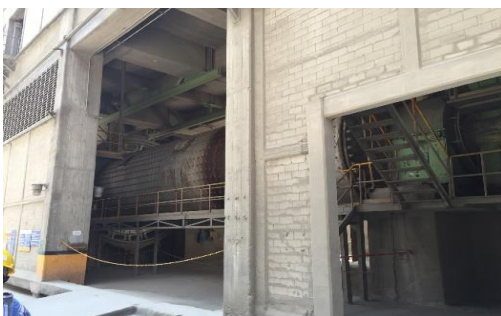
Figura 9. Molienda de Clínter y yeso para obtener cemento Portland (Fuente propia).
