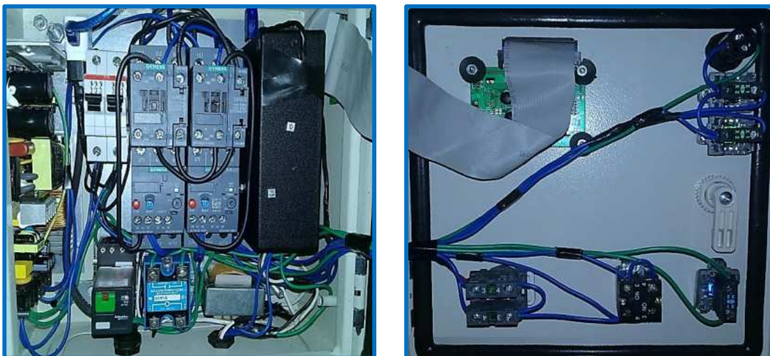
Figura 6. 3. Gabinete de control.
