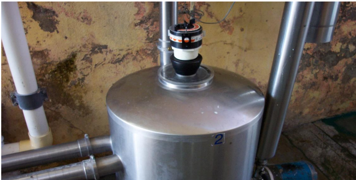
Figura 3 Tanque de recibo para cada lado de la sala en paralelo con dos líneas de 3 pulgadas para descarga de leche de 15 unidades conectadas a cada una
