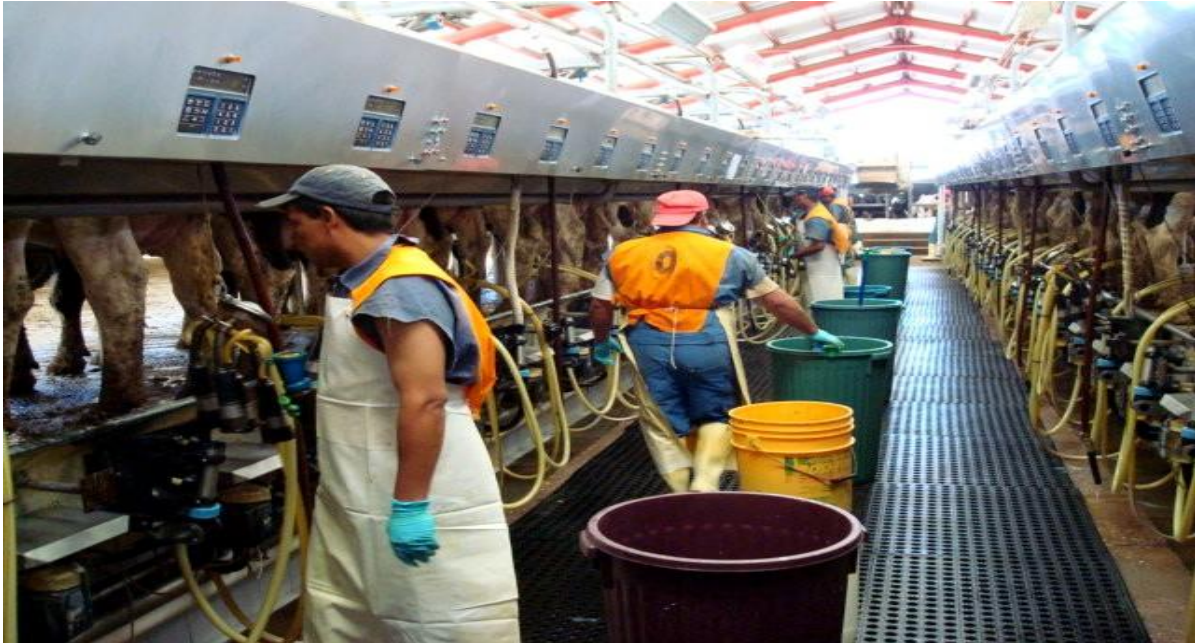
Figura 2 Sala en paralelo doble 30 en establo 1
