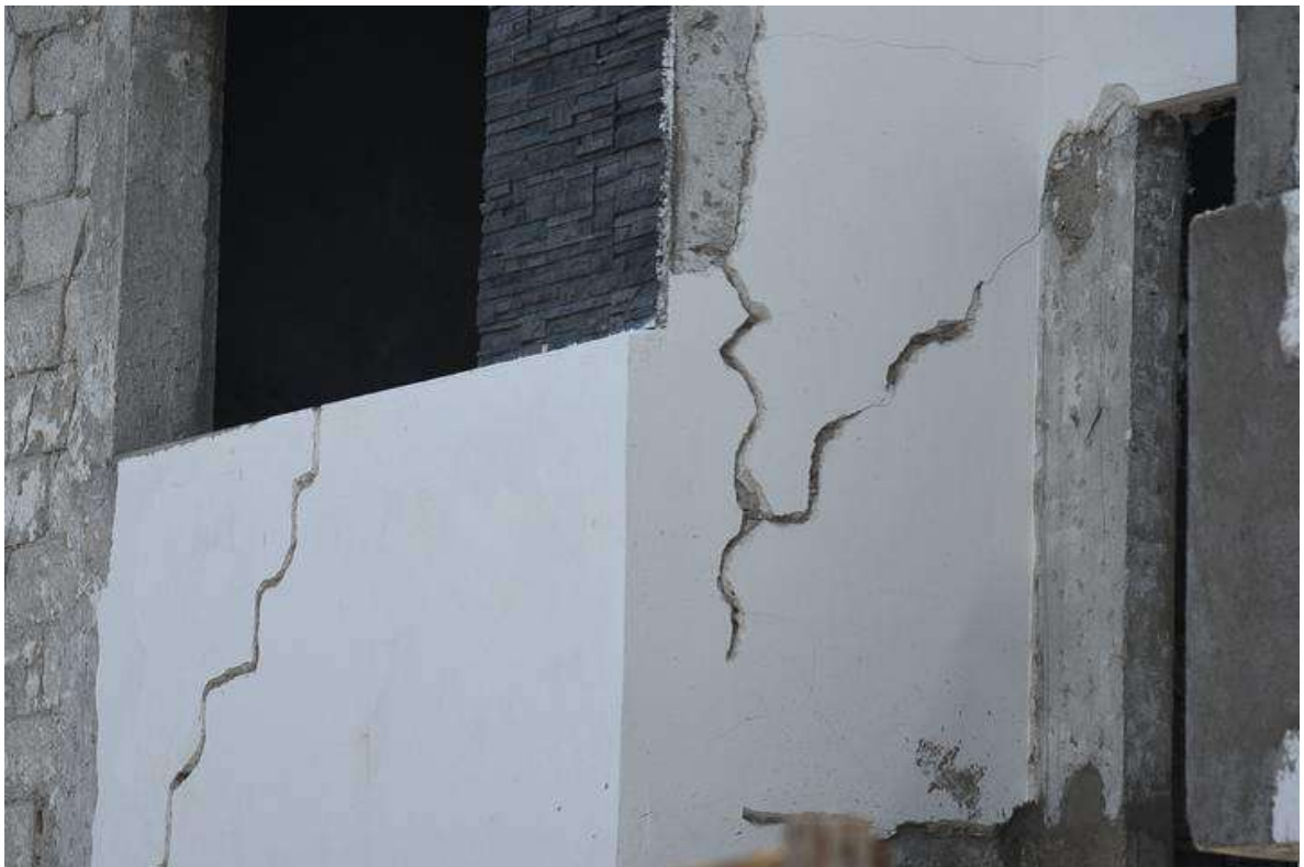
Figura 2. Agrietamiento de residencia del Fraccionamiento Misión del Parque en Santiago de Querétaro por presencia de suelos expansivos (Vázquez, 2022)
