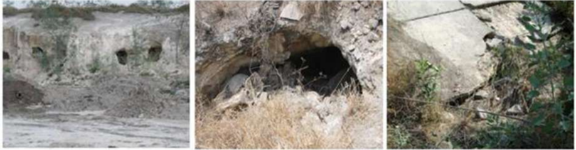
Figura 3. Suelos colapsables de Rioverde, San Luis Potosí: Oquedades en el subsuelo (izquierda), cavernas (centro) y estructuras colapsadas (derecha) (García-Ezquivel et al, 2023).
