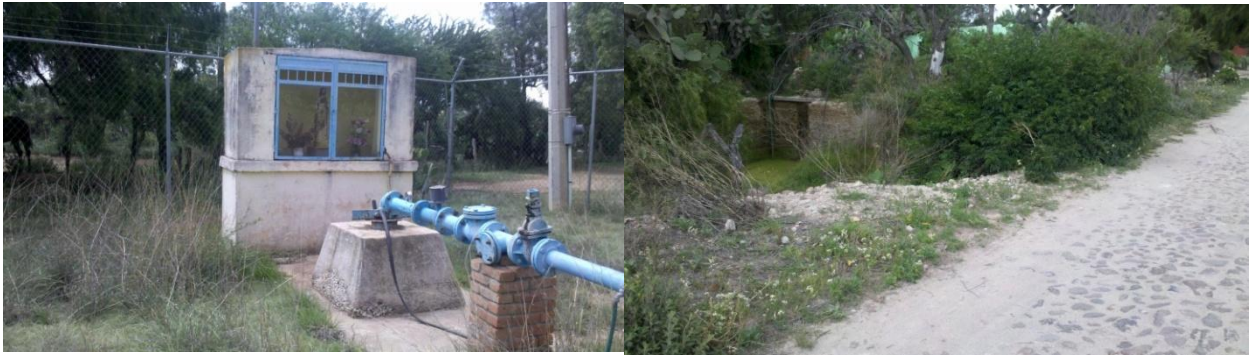
Figura 8.- A la izquierda, Pozo San Judas Tadeo en la localidad del Magueyal; Imagen de la derecha: Tanques junto al cauce principal, en el camino del Magueyal a San Isidro. Foto: Ernesto Granados
