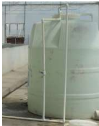
Figura 3.6. Tinaco de alimentación de agua para el sistema
