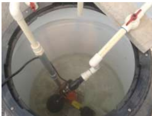
Figura 3.10. Tinaco y bomba sumergible para recirculación
