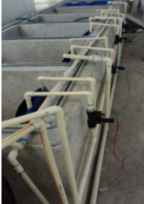
Figura 3.9. Tubería de recirculación de agua caliente en los estanques
