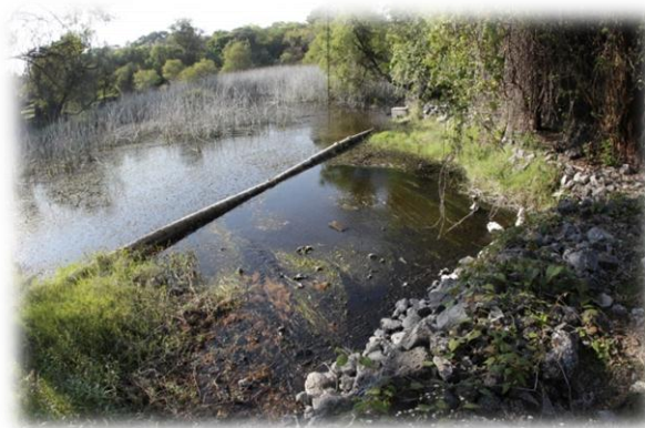
Figura 5.36. Tuberías sin ningún uso del Sistema Operador de Progreso
