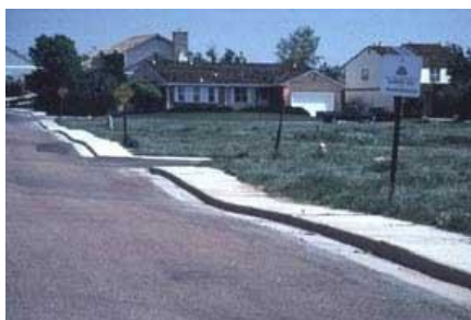
Figura 1.1 Movimientos diferenciales en el pavimento causados por arcillas expansivas
