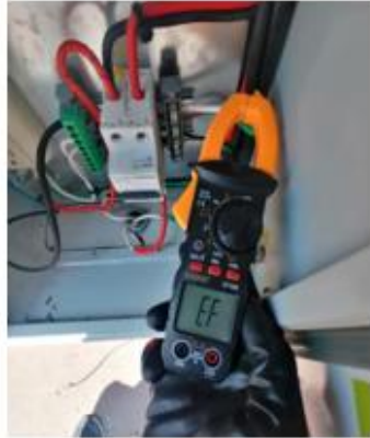
No continuidad a tierra
