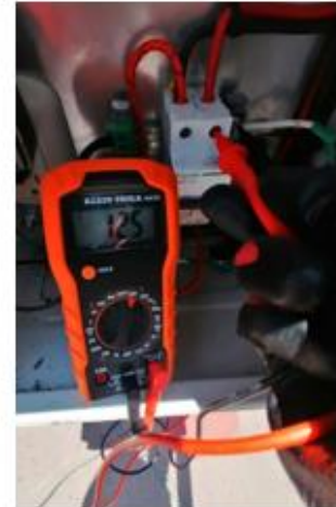
voltaje fase 2 a tierra
