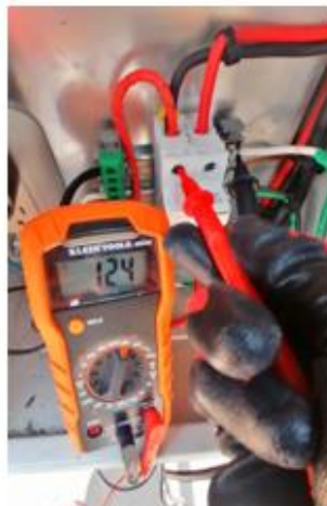
voltaje fase 1 a tierra
