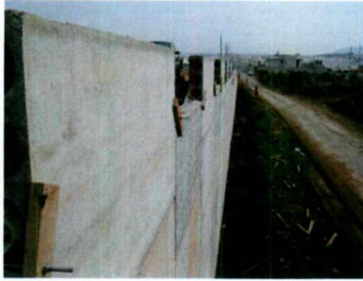
Foto 1. Puente de tierra armada en Juriquilla Querétaro Qro.
