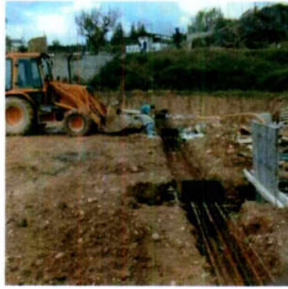
Foto 3. Cimentación a base de zapatas aisladas y contratrabes de la cafetería del Instituto Tecnológico de Querétaro en Jardines de Santiago en Querétaro Qro.
