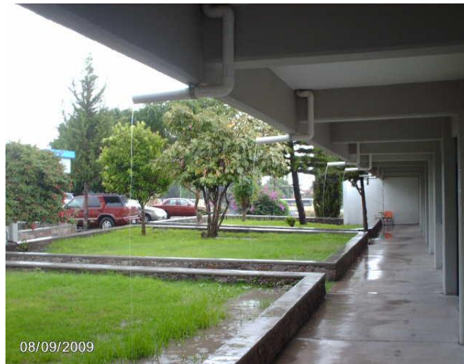
Figura 10. Tubos de PVC de 3” para la salida del escurrimiento
