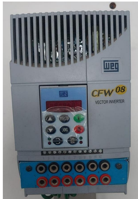
Figura 3.11: Variador de frecuencia utilizada (autoría propia).
