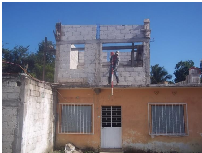
Figura 38. Casa en la cual se observa hasta donde llegó el nivel del agua producto de la inundación por el desbordamiento del río La Antigua.
